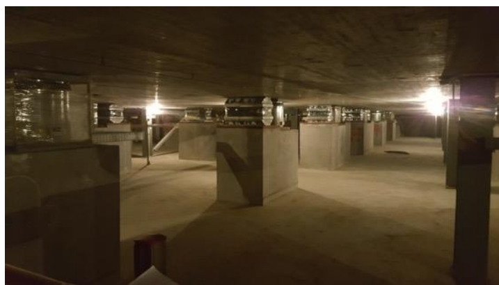
Imagine de la subsolul clădirii speciale ELI-NP arătând stâlpii de susținere cu arcuri și amortizare a platformei antivibrație.
