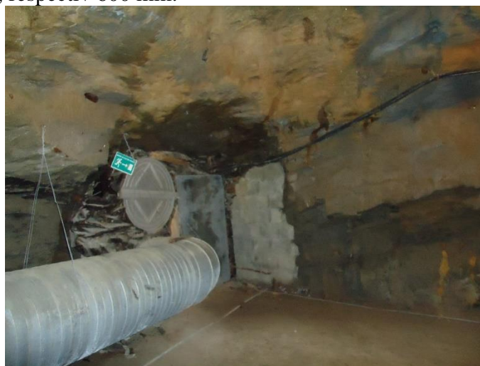
Sistem automat de ventilație a galeriilor subterane de depozitare
